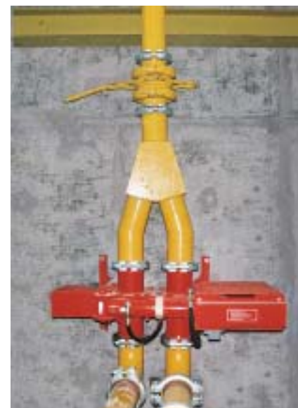
Distribution de boues et injection de lubrifiant. Tuyauterie IP 2 x 150 dans une installation de carbonisation de déchets à basse température
