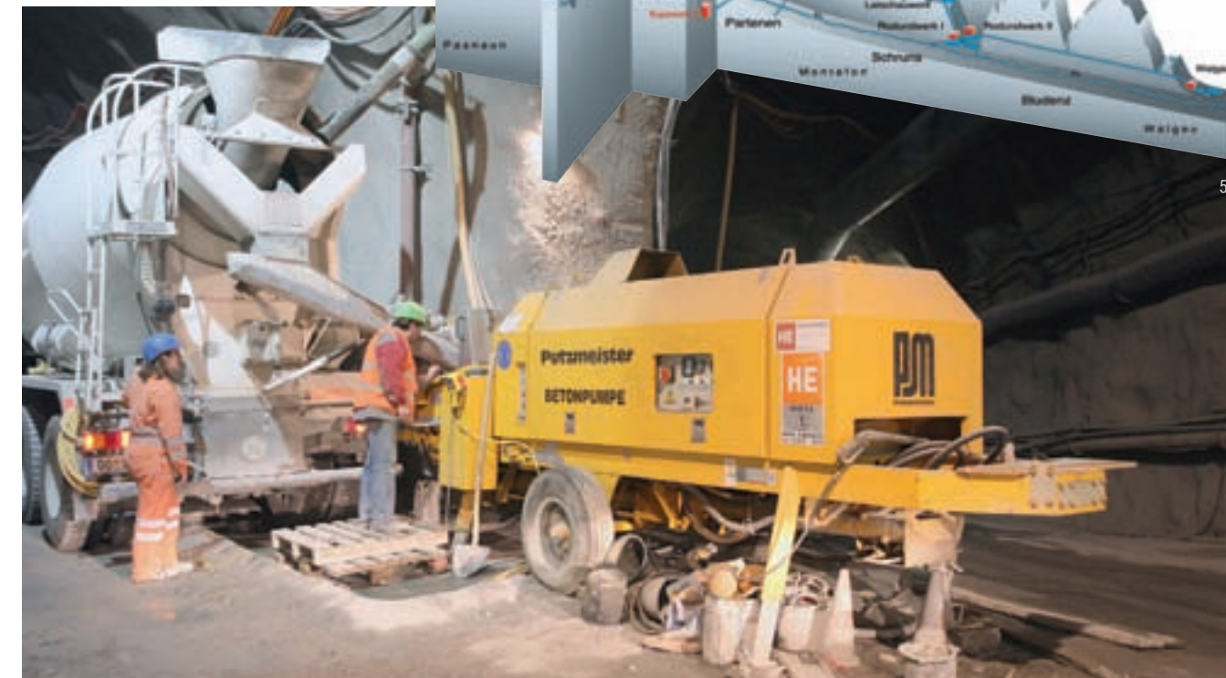
Die BSA 1408 E ist im Zufahrtstollen aufgestellt und über eine ca. 150 m lange Förderleitung mit beiden Rohrsäulen des MX-Mastes verbunden
