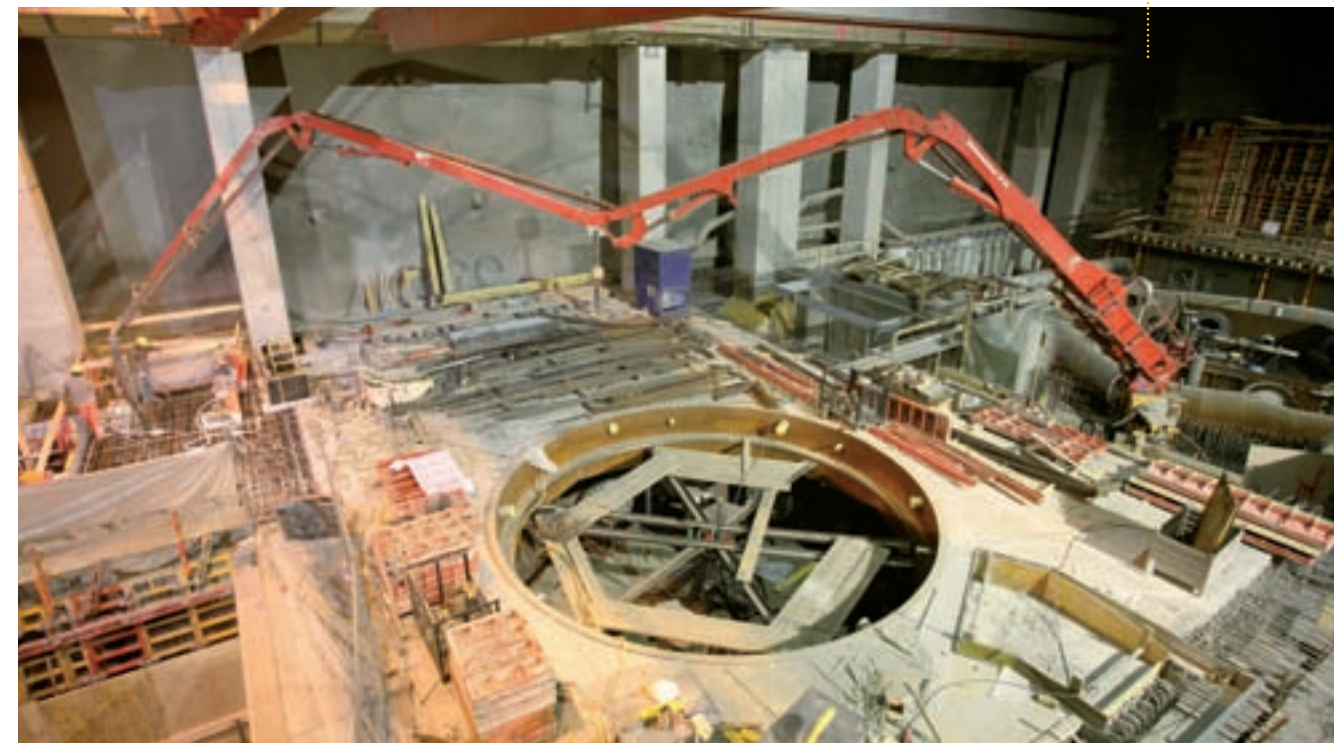
Der PM Stationärmast MX 28-4 mit „Z“-Faltung passt sich leicht den Platzverhältnissen in der Kaverne an und wird abwechselnd von zwei Rohrsäulen aus betrieben
